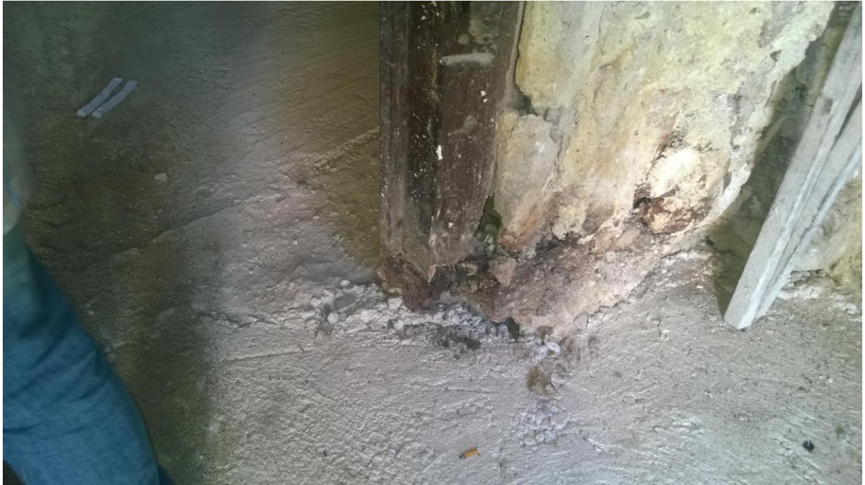
Pudriciones por humedad y retirada de mortero con cemento.
